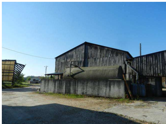
Cuve aérienne de gasoil (capacité 28 m 3 )
